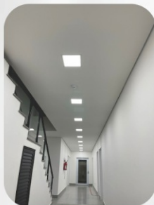
Forro em Drywall
